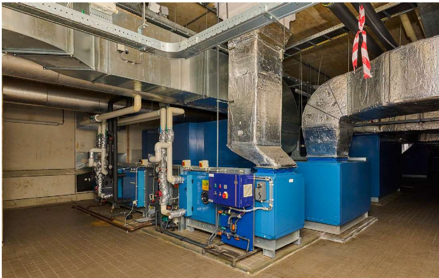
Foto 5: Ook een luchtbehandelingskast (LBK) uit het gebouw van ABN Amro kon worden hergebruikt. Alleen bleek dat de installateur, toen hij hem wilden weghalen, enorm veel moeite had om de LBK op een goede manier te demonteren. Er was namelijk geen instructie of handleiding hoe hij de LBK uit elkaar moest halen.
