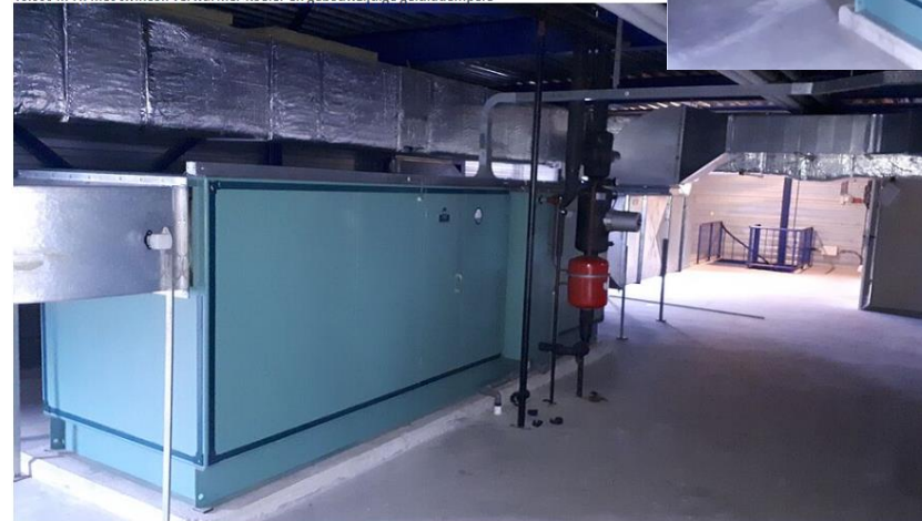
10.000 m³/h met twincoil verwarmers koeler en gebouwzijdige geluiddempers
